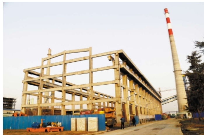
江苏通远热电有限公司热电联产技改工程项目建设高温高压参数 3×75t/h、2×20t/h 循环流化床锅炉,配套建设 2×86MW 背压式汽轮发电机组,同步建设烟气脱硫、脱硝、除尘装置,额定热效率为 82.5%,满足化工园区的热用户需要。当前,土建主体完工,1 台 75t/h 及 2 台 20t/h 锅炉及 1 台 6MW 机组设备安装调试。2 台 20t/h 锅炉建成投产,厂房结构封顶,正在进行墙体施工、砌体密封,锅炉本体安装完成,锅炉施工正在进行,循环水/炉内水处理、干燥间、开闭站正在施工,灰库、烟道封顶,环保设备正在安装阶段。图为建设现场。本报记者 陈敬波
