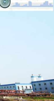
新奥农牧项目位于新沂经济开发区,项目计划建设2条屠宰生产线、3条丁腈素生产线,主要生产品种为水溶性微胶囊脂肪粉系列产品(脂肪素)和饲料丁腈素,致力于打造绿色生态农牧产品精细化学产业链。图为新奥农牧项目施工现场。
