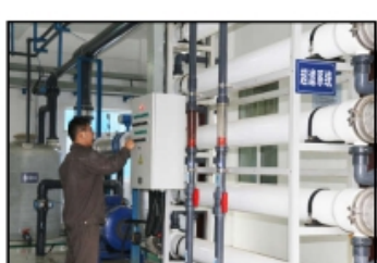
危险废物转移项目(污水处理)
