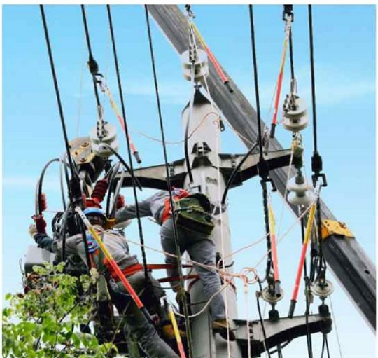
为做好迎峰度夏工作准备，保证城区供电稳定可靠，近日，市供电公司城区大桥路10千伏四工、10千伏四南线开展线路综合检修。 本报通讯员 赵超/摄
