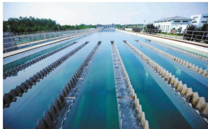
为推进城乡统筹发展,我市实施了城乡供水一体化工程,并出台《新沂市城乡供水一体化建设实施意见》,对城乡供水一体化建设和农村供水进行水质全面管控和建设的水平监测检测设施,对原康店水厂进行二期工程扩建,新建康店地表水厂,开发宝泉自来水厂,全面提升供水能力。历时两年多的新沂市城乡供水一体化主体工程已于去年年底收官,110万新沂人将喝上“同水源、同管网、同水质、同服务”的同一流水,因为原康店地表水厂。
